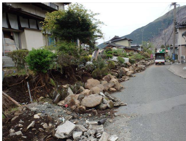
石積み擁壁の倒壊
