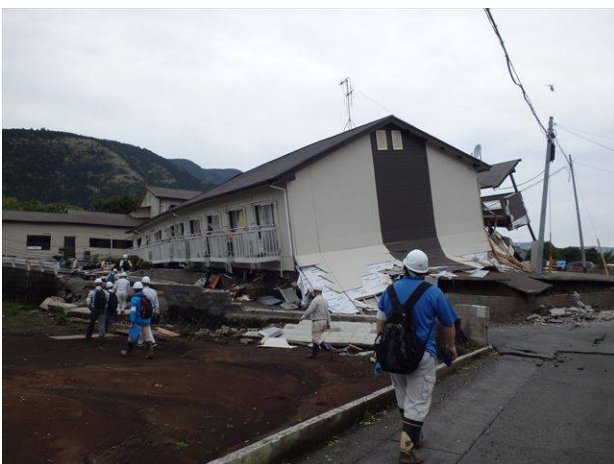
アパート1階部分の倒壊
