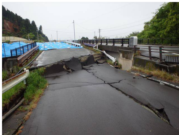
橋とアプローチの段差
