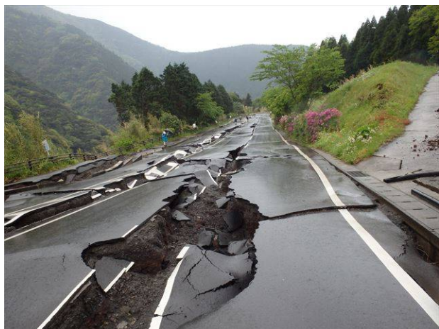
道路盛土部分の変状
