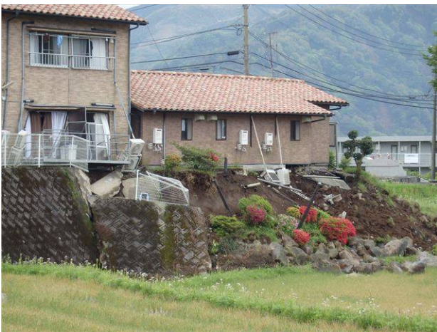
石積み擁壁の倒壊と盛土の崩壊
