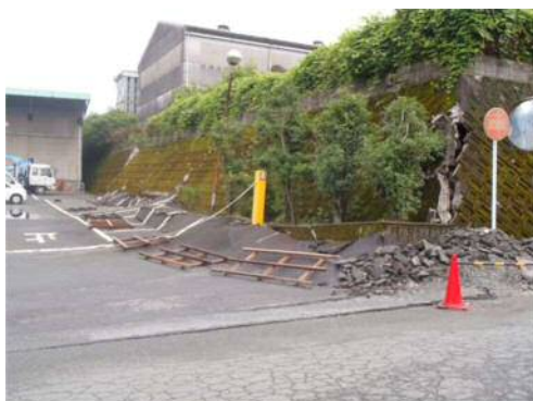
阿蘇南工業団地の空撮映像と盛土の滑動崩落範囲。赤丸の位置が地上写真撮影場所
