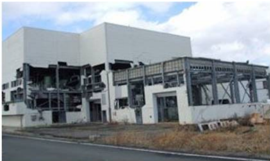
被災した処理場
