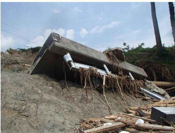
転倒した橋桁
