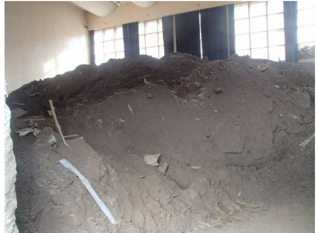
小学校の講堂に堆積した土砂
