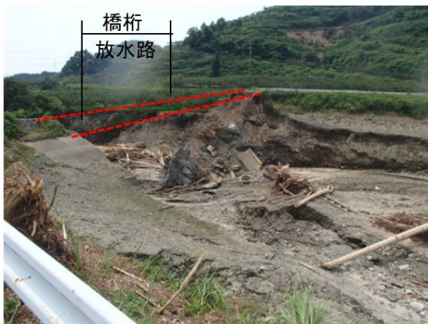
堤体の破堤前と破堤後
