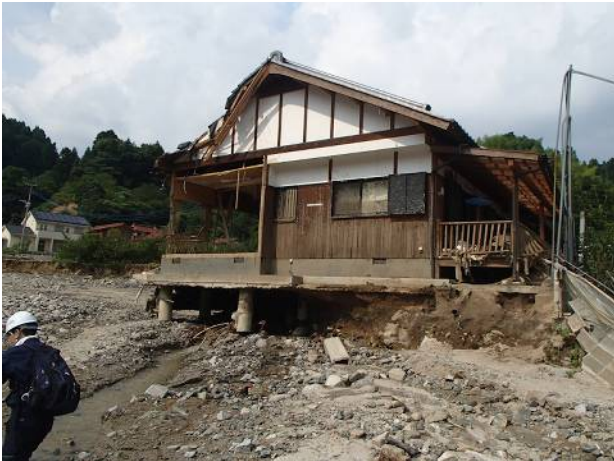
破壊された家屋
