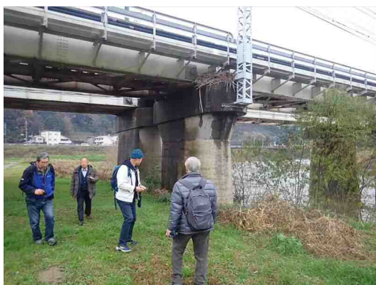
大和川の JR 鉄橋に出水時にかかったゴミ
