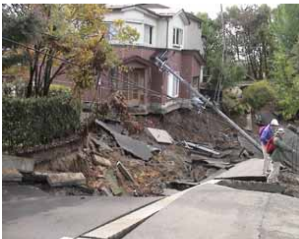
写真3 高町団地内の谷埋め盛土の崩壊
