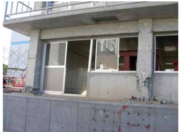
（前回（無補強）9月の実験状況 基礎を振動台に剛結した実験後で柱の圧縮破壊が見られる。
