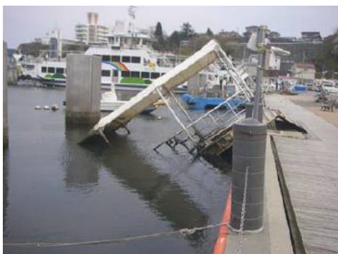
2014年11月 被災したままのフェリー乗り場
