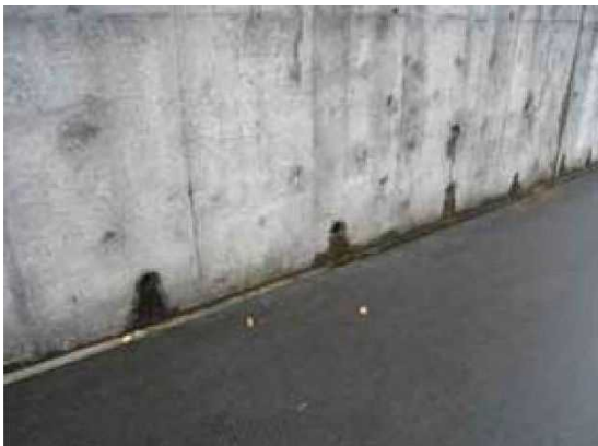
複数の水抜き穴から出水(良好とする)
