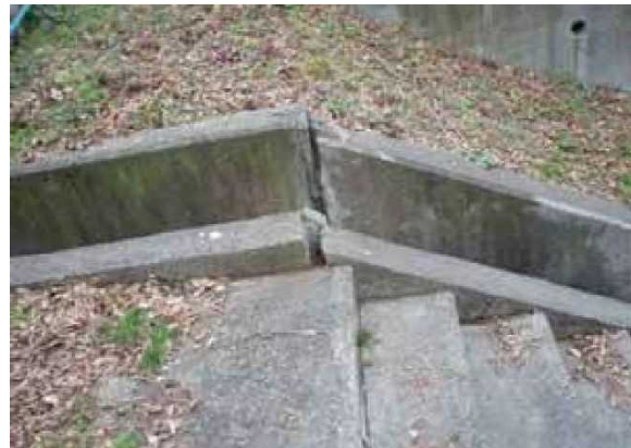
排水路の変形(盛土の沈下起因)
