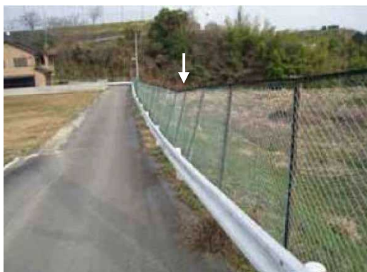
フェンスの傾斜
