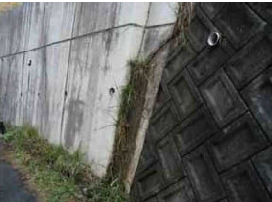
擁壁クラックから出水・植生あり
