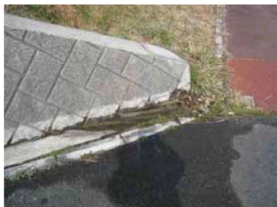
擁壁下端から出水
