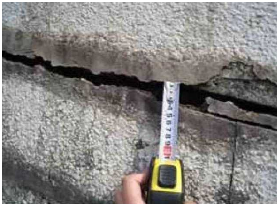
亀裂幅の測定
