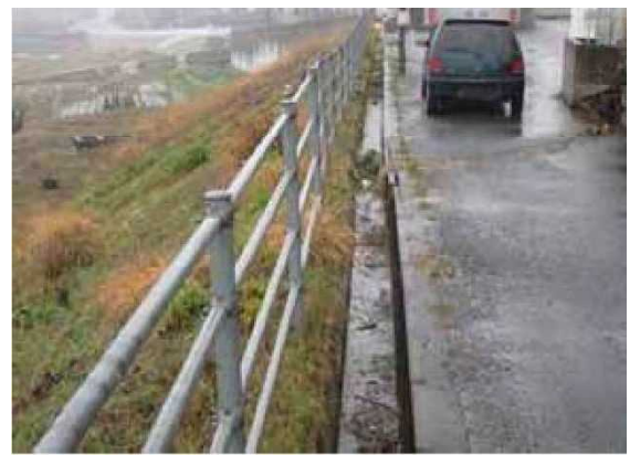
擁壁天端の側溝の開口
