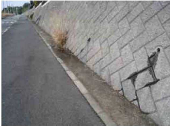
亀裂開口部から出水
