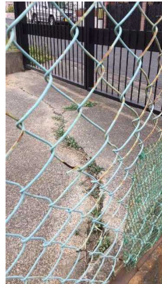
住居敷地内の亀裂
