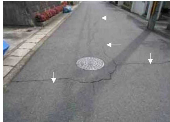
道路縦横断亀裂
