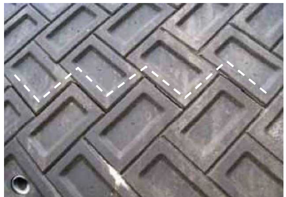
連続した目地の開き(水平亀裂)
