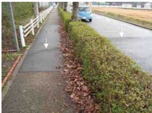
歩道部の横断亀裂
