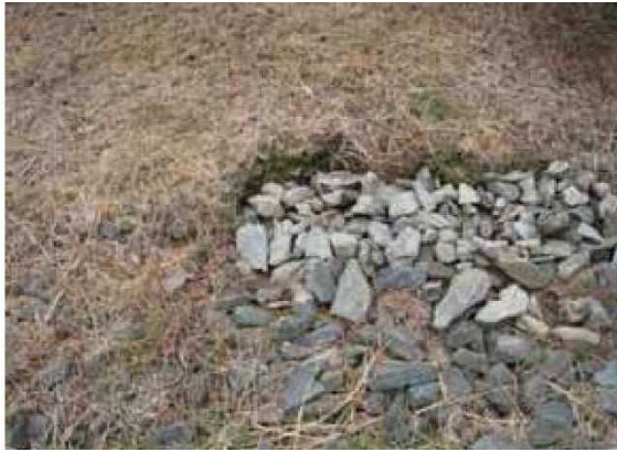
のり面崩壊跡(ぐり石で保護されている)
