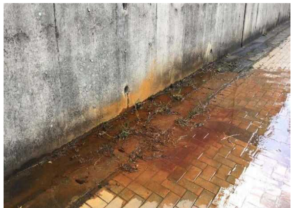
水抜き穴から酸化した水
