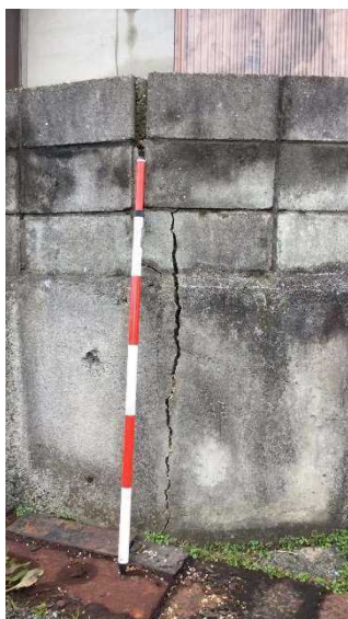
ブロック塀の縦亀裂
