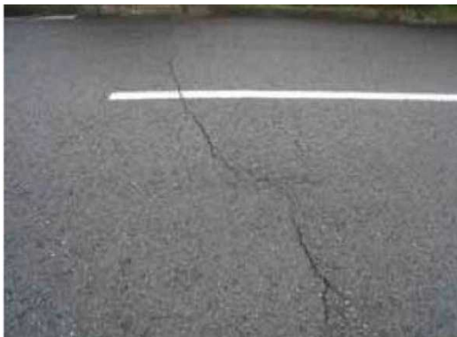
道路横断亀裂(連続した亀裂)
