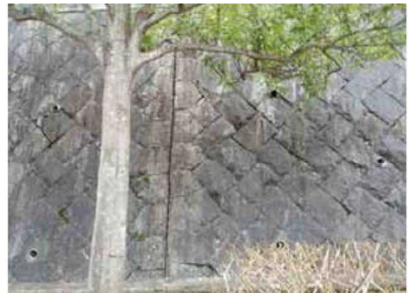
亀裂から出水
