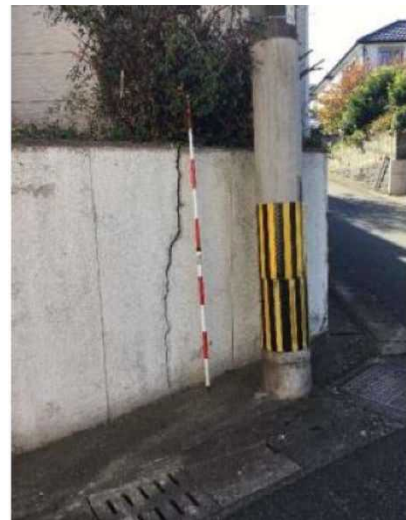
住居塀の亀裂
