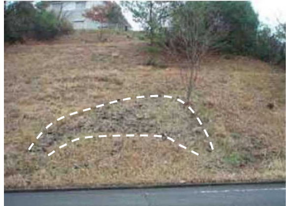
のり面崩壊跡
