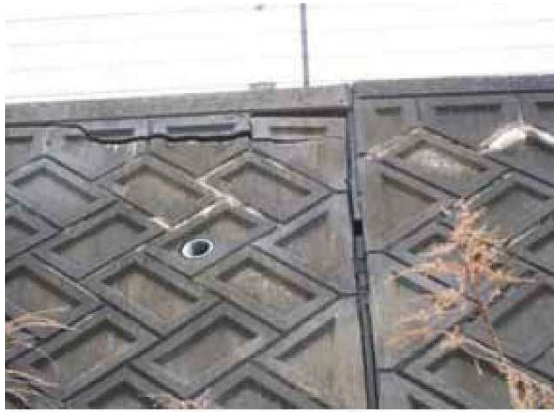
擁壁天端の水平クラック
