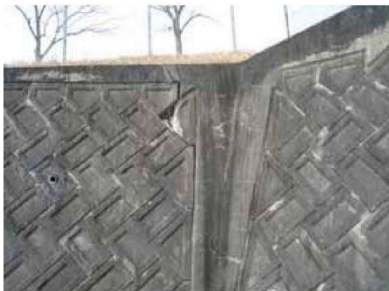
出隅部の欠損
