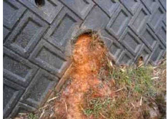
水抜き穴から土砂=内部が空洞化の可能性
