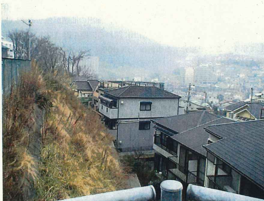
図 2.1.4 下流部の盛土が変動したため不安定化したものと推測される（湊川-08）
