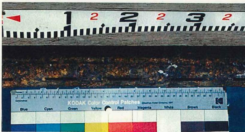
図 4.3.1 盛土中に 20 数年間埋設されていた黒皮の有孔鋼管の状態
