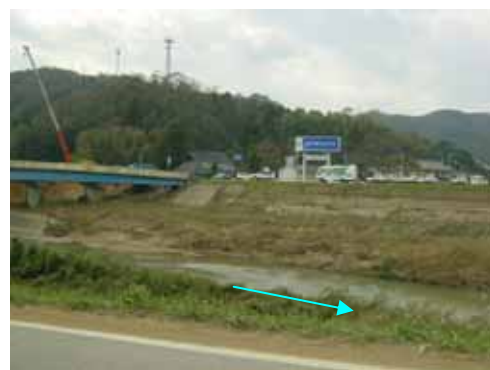
同左。鳥居橋に流木が詰まり，下流の左岸が決壊した。桁の下には今も流木が堆積する。
