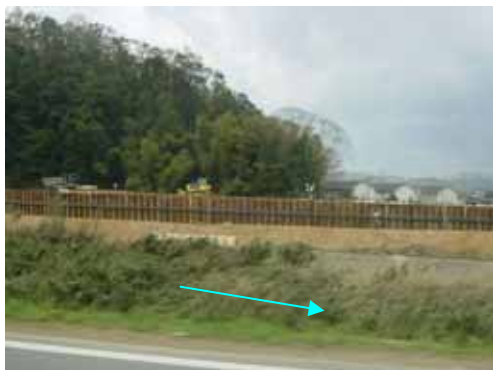
出石町鳥居地区復旧状況。延長 200m にわたり破堤した。このすぐ下流に鳥居橋がある（右写真）。
