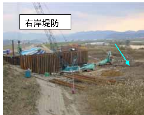
11/3 撮影：復旧作業。堤内側を矢板で締切り、堤防工事中（施工延長 200m）。写真手前には立野大橋がある。
