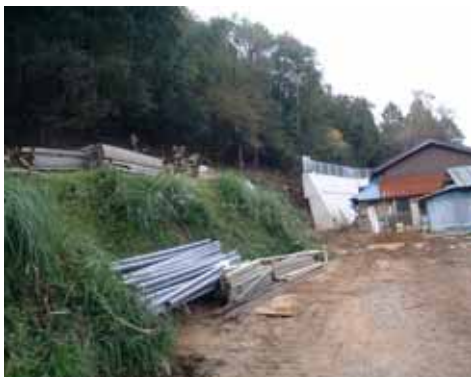
但東町佐々木。工事中に崖崩れで被災。
