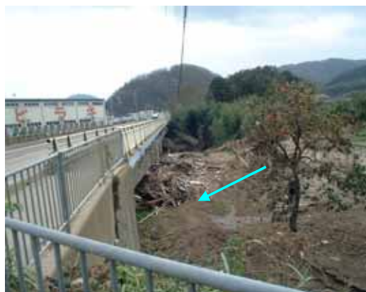
国道 312 号 日高町朝倉地区尾川橋付近（稲葉川）。橋の下に流木が堆積し、閉塞している。
