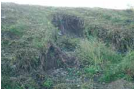
堤防の末端部に見られた小崩壊
