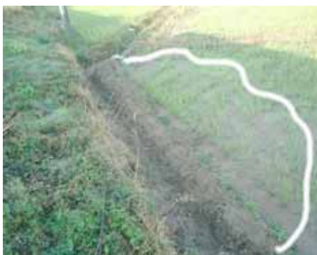
パイピングにより吹き出した土の跡
