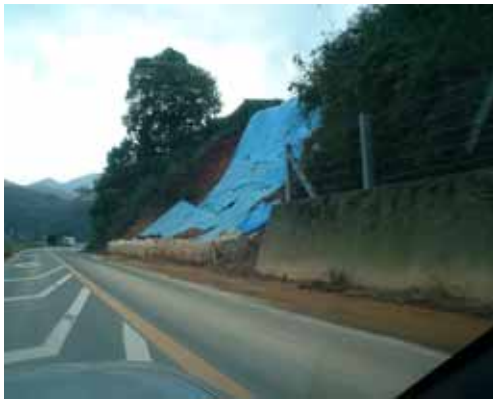
但東町矢根地区。出石川に併走する道路際の崩壊。土砂や木が出石川へ流入した
